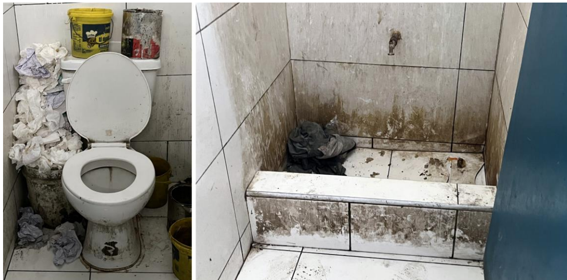
Lors de leur visite de septembre 2024, les chercheuses d'Amnesty International ont constaté que les installations sanitaires dans les sites pour personnes déplacées n'étaient pas accessibles aux personnes en situation de handicap. © Amnesty International
